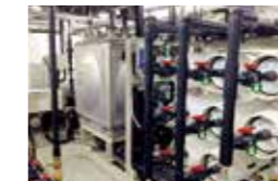
排水リサイクル設備
