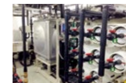
排水リサイクル設備
